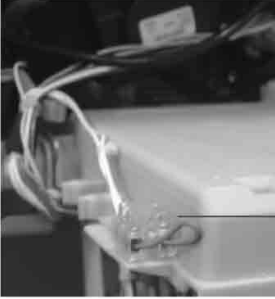
Oda termostadı bağlanmamış
