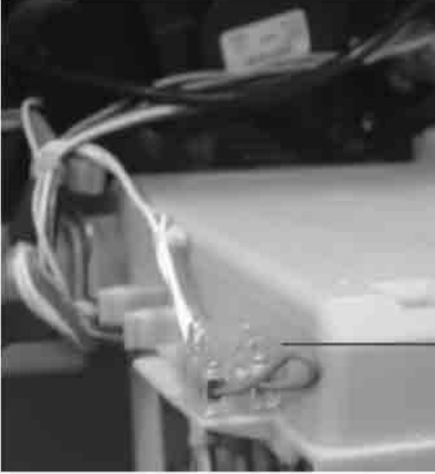
Oda termostadı bağlanmamış
