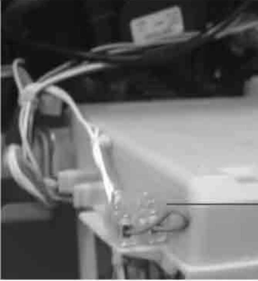
Oda termostadı bağlanmamış
